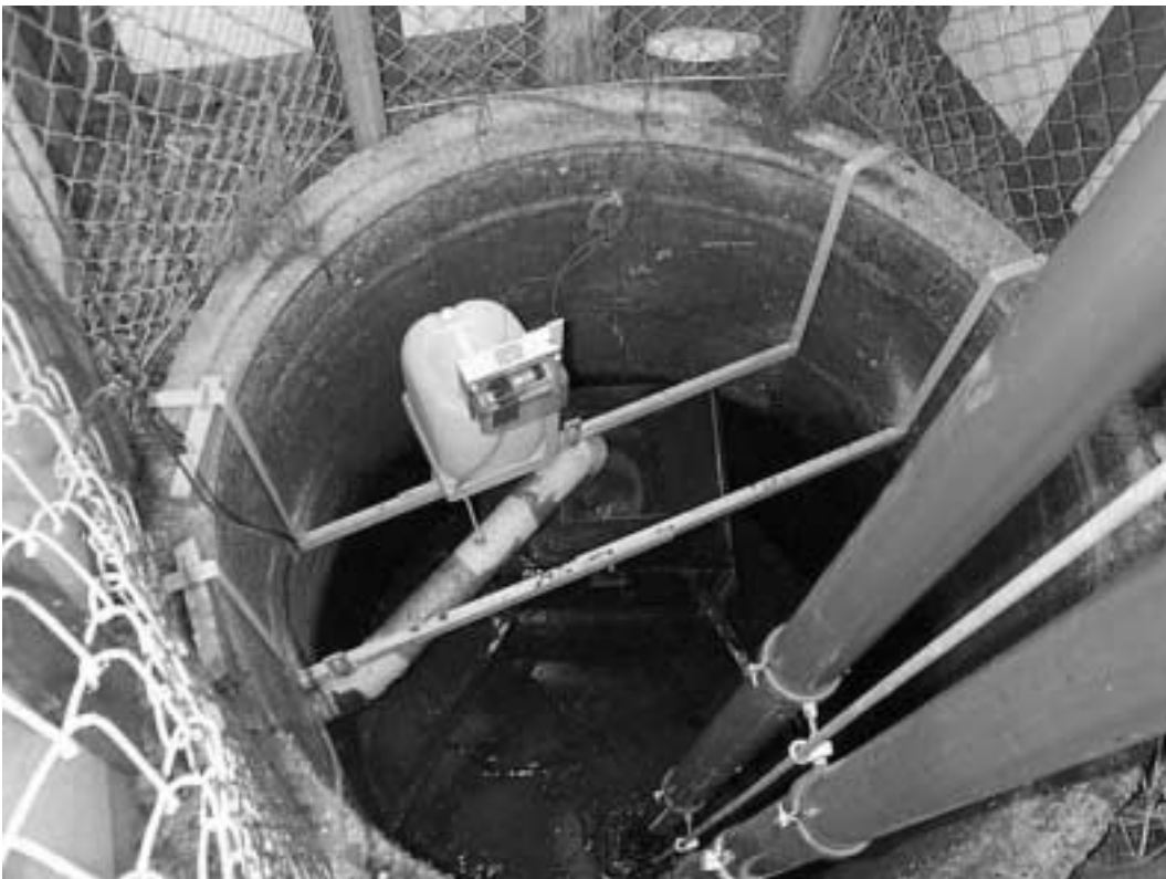
Bild 6. Pumpbrunnen med installerat vippkärl.
