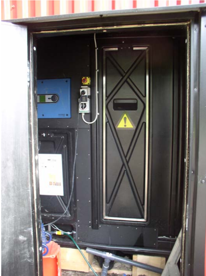
Bild 4: Scrubber med två filter som spolas med vatten.
